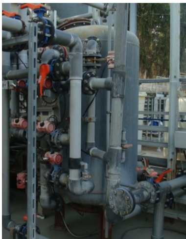
Figura 5.3.1.5.1. Filtre de sorra CWP.SF1.
