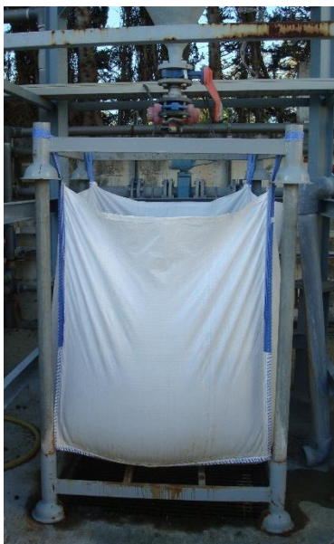
Figura 6.2.3.1. Big-Bag filtrador situat a la sortida del decantador TR.WSF1.
