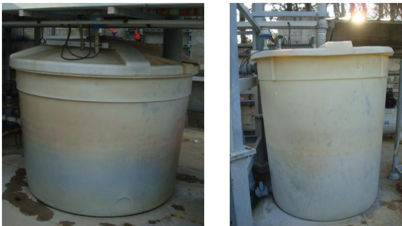
Figura 5.3.1.7.1. Tancs DWP.DP2 i TR.DP1 d'esquerra a dreta.
