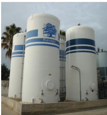
Figura 5.3.1.6.1. Tancs HOP.DP1, HOP.DP2, HOP.DP3.
