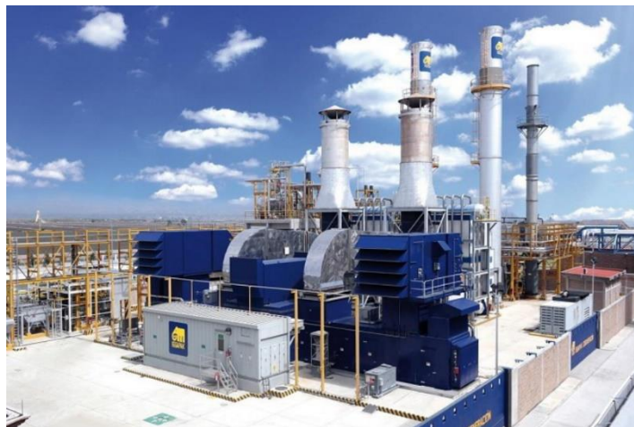
Figura 13. Planta de cogeneración.
