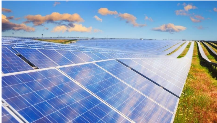
Figura 3. instalación solar fotovoltaica.
