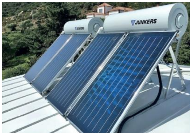
Figura 5. Instalación solar térmica.
