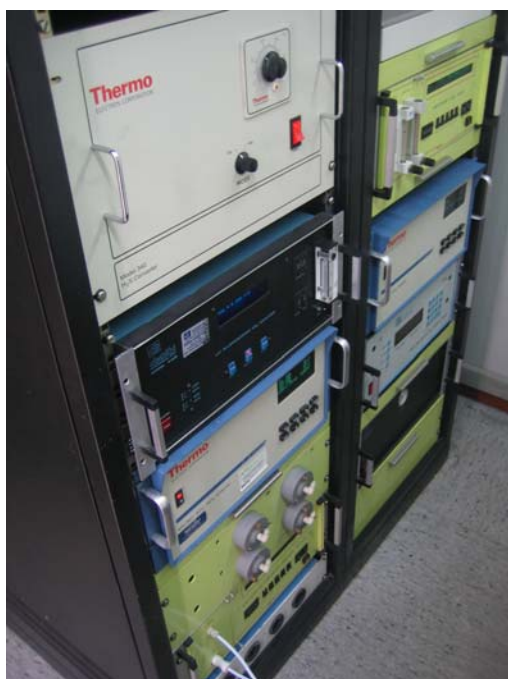
Foto 12. Els aparells de mesura de l'estació col·locats en forma de dues torres.
