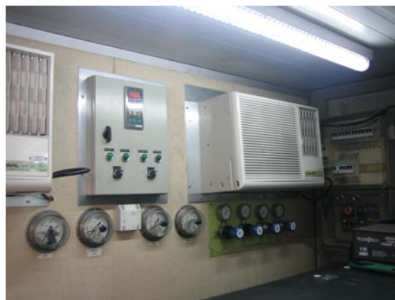
Foto 11. Sistema d'aire condicionat de l'estació automàtica.
