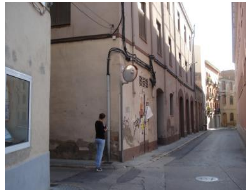
Figura 5 - Transformador del carrer Paborde.
