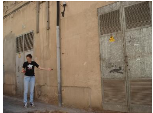
Figura 6 - Transformador del carrer Hort dels alls.
