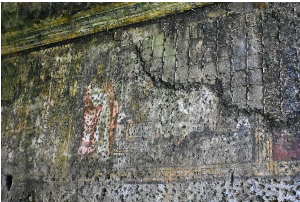
FIGURA 3. Marcas do roubo dos azulejos e figura masculina pintadas, provavelmente da decoração original da capela. Fonte: dos autores do presente texto.
