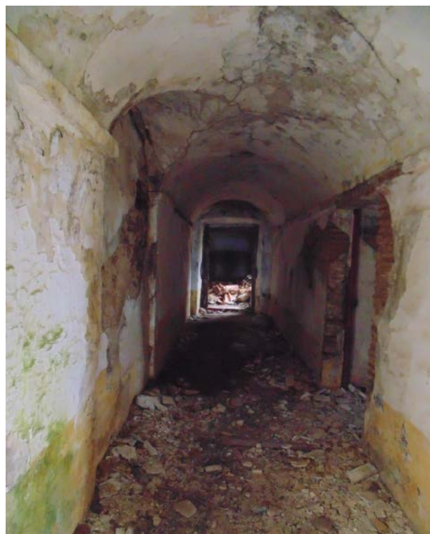
FIGURA 4. Amostra do acentuado estado de degradação da estrutura religiosa.
