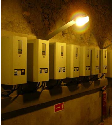
Fotografia 3.5. Disposició dels inversors
