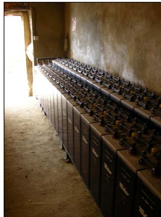
Bateria d'acumuladors existent
