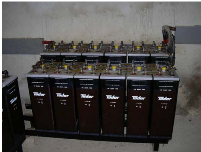
Figura 2.29. Instal·lació existent de les bateries
