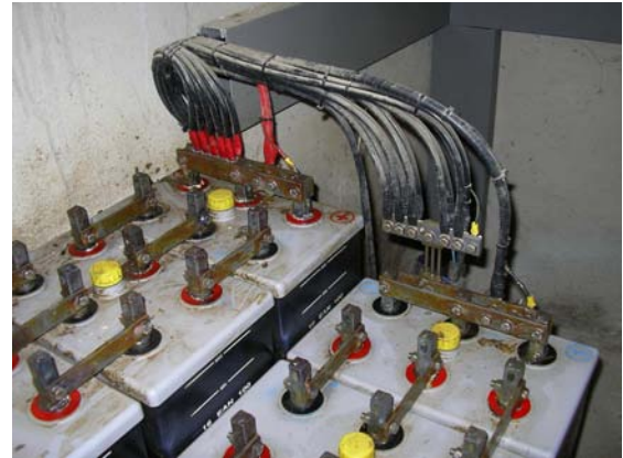
Fotografia 3.10. Detall connexionat bateries
