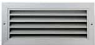
Figura 38. Reixa aire acondicionat.
