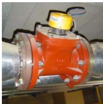
Figura 30: Unió amb brides metàl·liques
