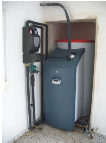
Figura 43: Sistema auxiliar amb caldera de gas
