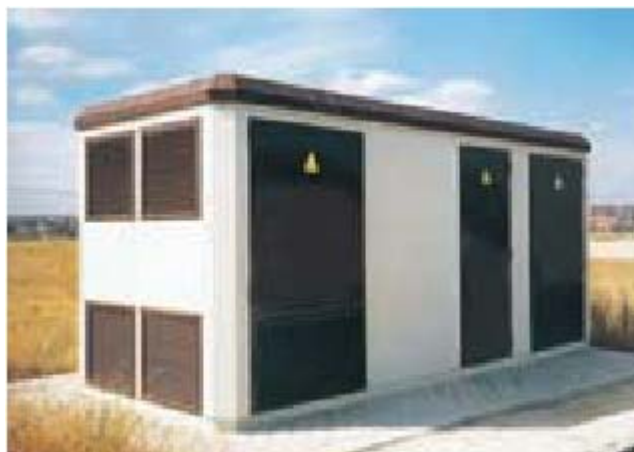
- Figura 2. Centro de transformación Ormazabal -
