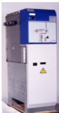
- Figura 8. Celda de protección -
