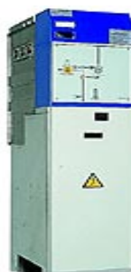
- Figura 7. Celda de línea -
