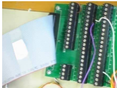
Figura 6.6: Conexión de dos cables en las salidas del convertidor D/A0 y tierra en una tarjeta CIO-MINI50
