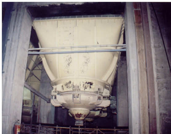
Figura 2. Tolva entrada producto
