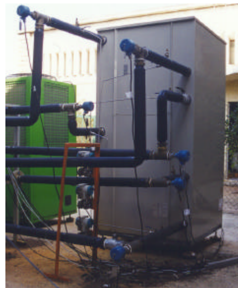
Fig.5. 6 Fotografía de la instalación del equipo Yazaki WFC-10, en el banco de ensayos
