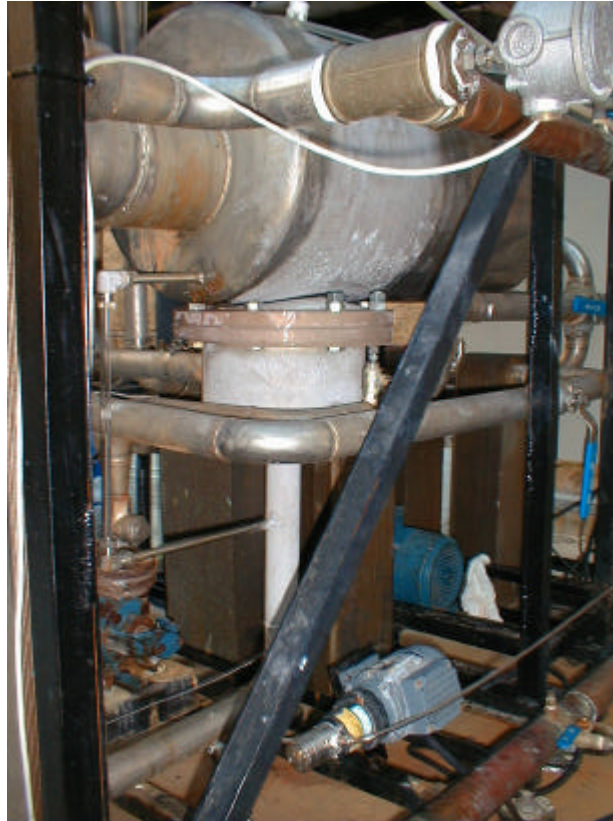
Fig. 6. 7 Fotografía del prototipo operando en modo calefacción, en donde se visualiza la formación de hielo en el tramo de purga del evaporador, mientras que la escarcha desaparece al aproximarse al evaporador.
