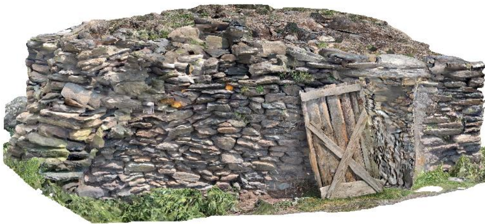
Figura 5.53. A dalt fotografia de l'estructura E230 (esquerra) i vista general del tancat E229 (dreta). A sota model fotogramètric generat amb LiDAR del refugi modern de Cabanella (E228).
