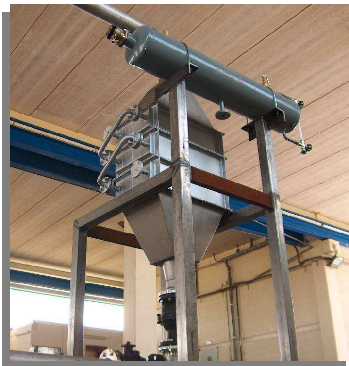
Figura 3-29. Situación del depósito de expansión en la parte superior de la instalación.
