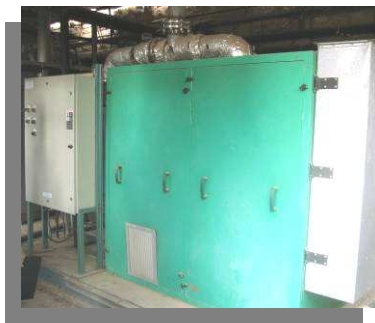
Disposición inicial de la Microturbina de gas Capstone C30
