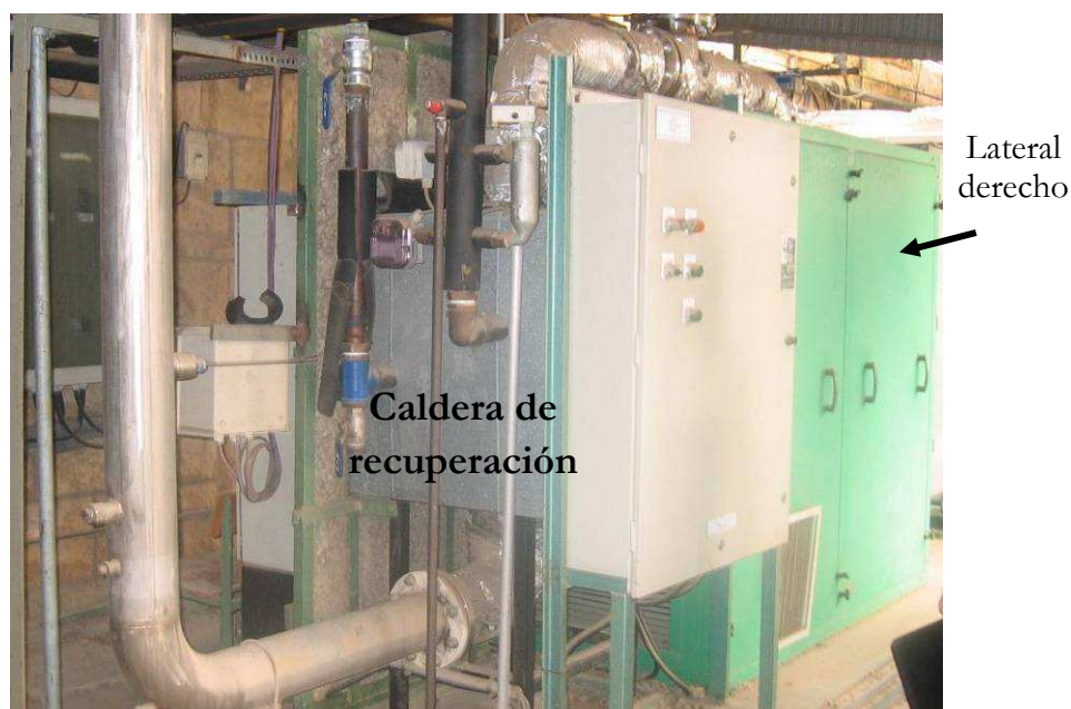
Figura 3-4. Microturbina Capstone C30 y caldera de recuperación de calor para ACS.
