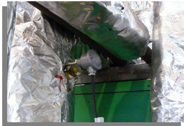
Figura 4-11. Sensor de temperatura de gases de escape situado entre el intercambiador de aceite y la caldera de recuperación [Tgs].
