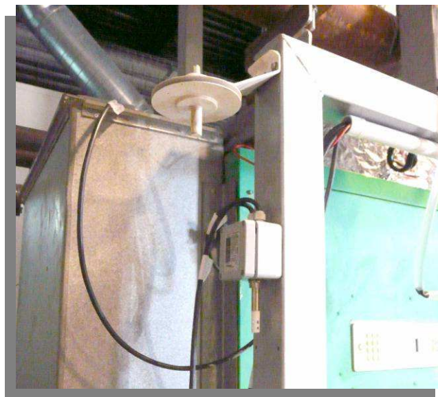
Figura 4-10. Transmisor de temperatura ambiente y humedad relativa instalado en la estructura de la microturbina junto a la entrada del aire exterior.
