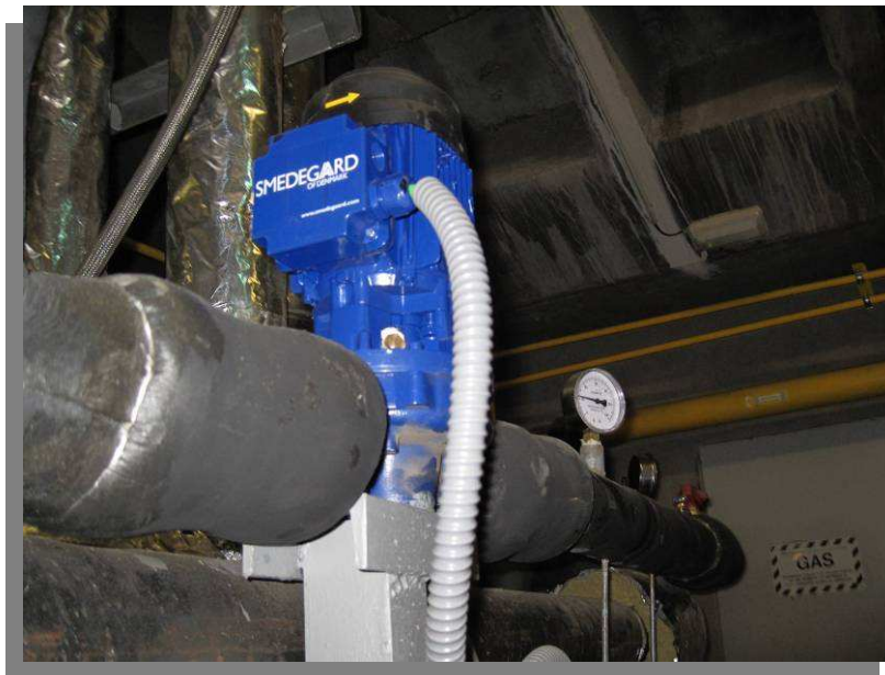
Figura 5-12. Bomba de circulación del circuito de agua caliente a la entrada de la caldera de recuperación de calor para ACS.
