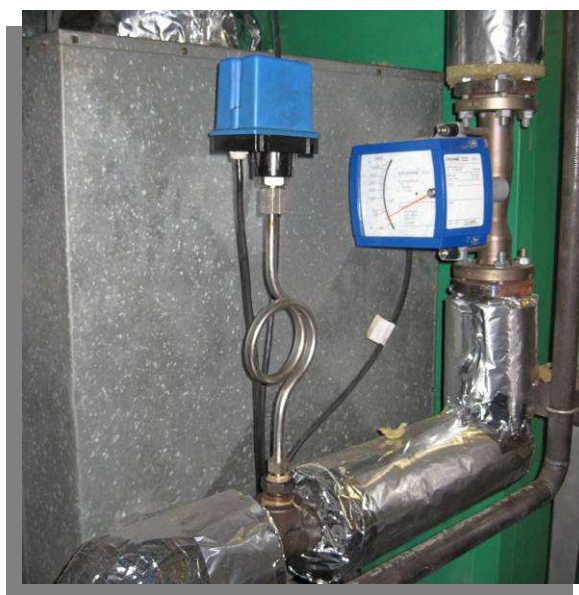
Figura 3-36. Presostato circuito de aceite térmico instalado en el sistema de trigeneración.
