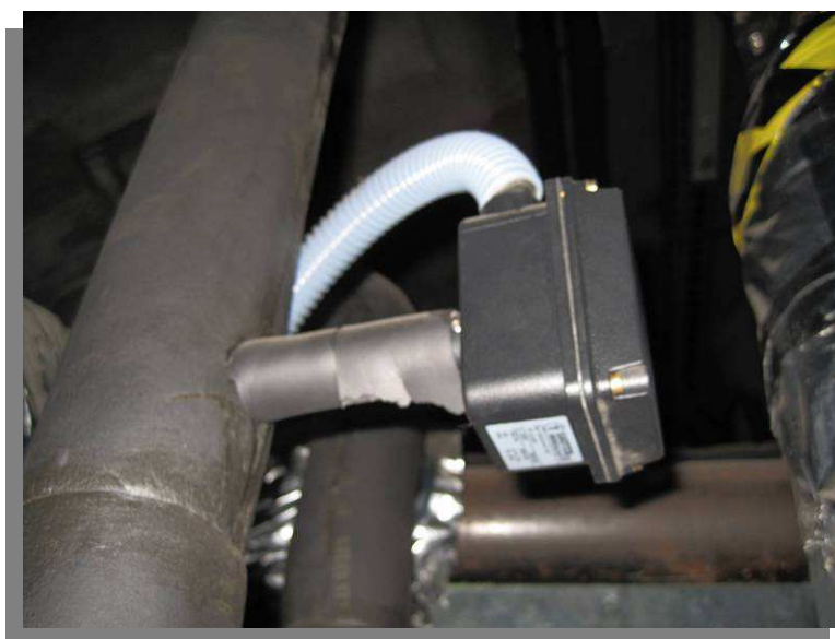
Figura 5-14. Termostato del circuito de agua caliente del sistema de trigeneración en el edificio Central Fòrum.
