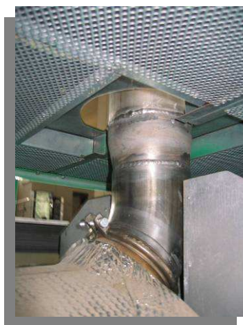
Figura 3-39. Conducción de gases de escape a la salida de la microturbina de gas
