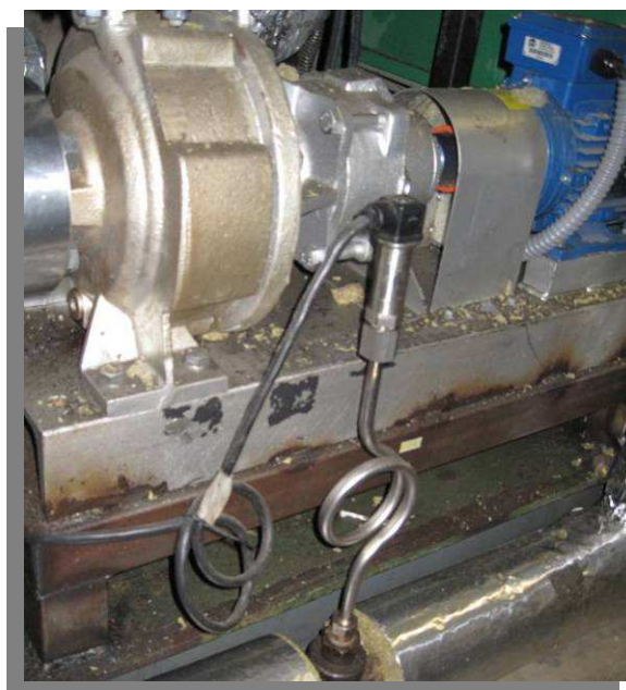
Figura 4-20. Transmisor de presión de aceite térmico instalado en el sistema de trigeneración.
