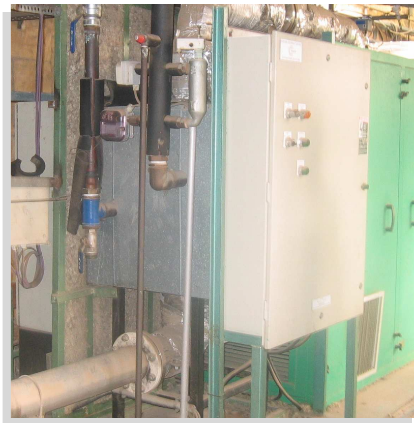
Figura 3-14. Caldera de recuperación de calor para ACS integrada en el paquete original de la microturbina.
