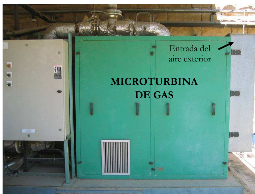
Figura 3-3. Microturbina de gas Capstone C30 suministrada por la compañía G.A.S. Energietechnik GmbH.
