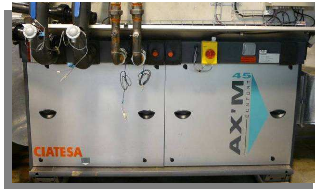
Figura 4-1. Unidad de tratamiento de aire.
