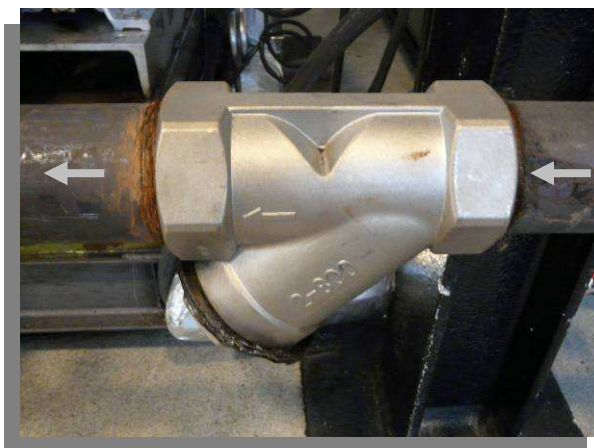
Figura 3-31. Filtro Y PN64 instalado en el circuito de aceite térmico.
