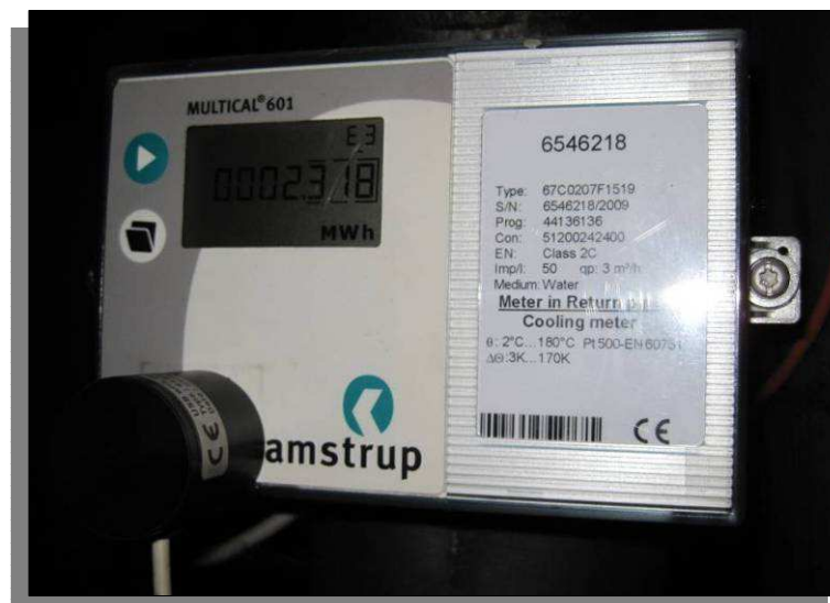
Figura 5-13. Medidor de caudal y temperatura del agua fría Kamstrup en la central generadora Central Fòrum.
