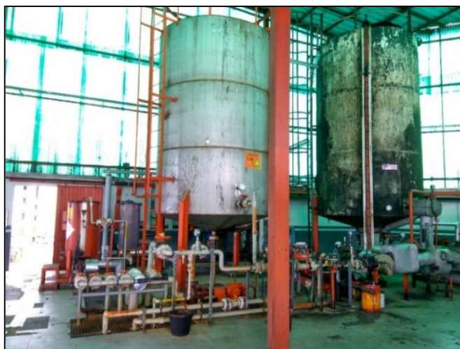
Figura 3.2. Planta de fabricación de emulsiones.
