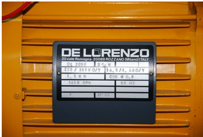
Figura 19. Placa de característiques del motor trifàsic.
