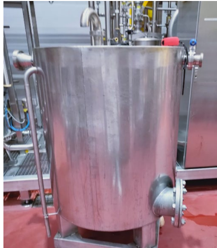
Figura 7.3.1 Tanque reutilizado para recuperar el agua en CIP de la fábrica 2.
