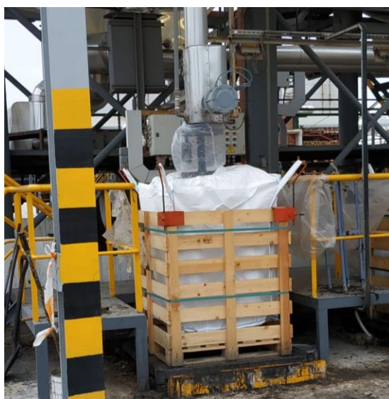
Figura 2.2. Zona actual de llenado de big bags .
