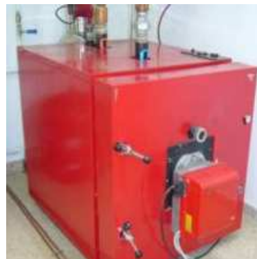
Figura 1.24 Caldera de gasoil.
