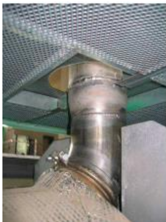
Ilustración 62. Conducción de gases de escape a la salida de la microturbina. CREVER - URV.
