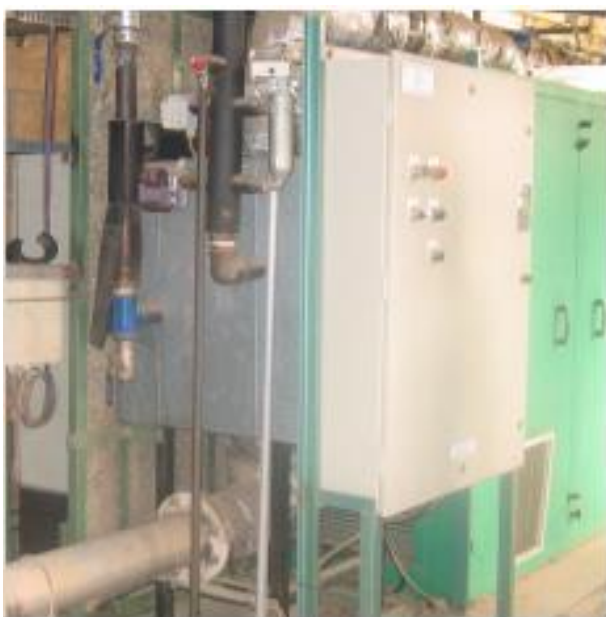
Ilustración 60. Caldera de recuperación para ACS integrada en el paquete original de la microturbina.
