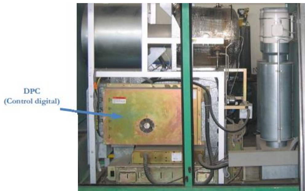
Ilustración 58. Interior microturbina Capstone C30 lateral izquierdo. CREVER - URV
