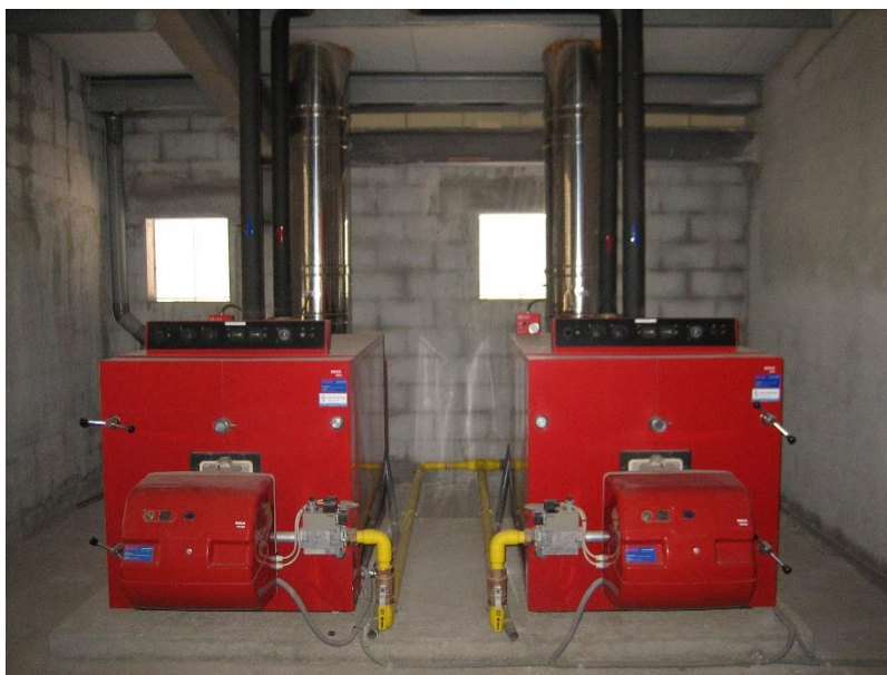
Ilustración 49. Situación actual de las calderas ROCA modelo CPM 300 en el CDM de Bonavista.
