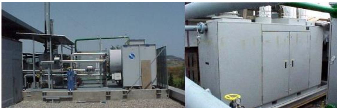
Ilustración 25. Vista general de la instalación y detalle de la microturbina.
