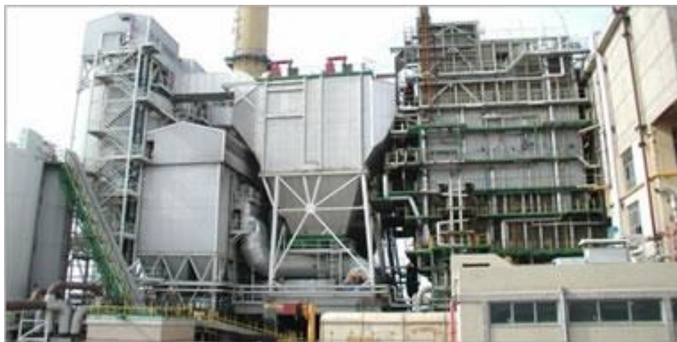
Ilustración 20. Planta de Residuos de Melilla (REMESA).
