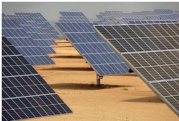
Ilustración 15. Instalación de energía solar fotovoltaica
