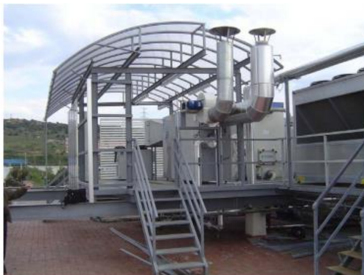
Ilustración 26. Vista general de la instalación en el edificio de Gas Natural en Montigalà.
