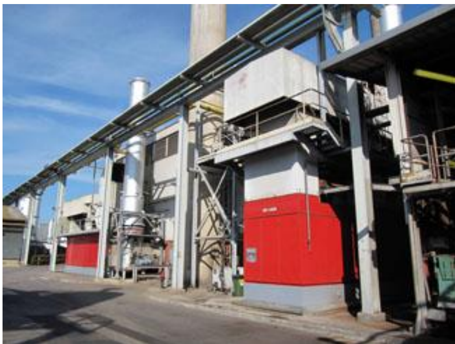
Ilustración 4 . Emplazamiento de los equipos de generación de la Universidad de Santiago de Compostela
