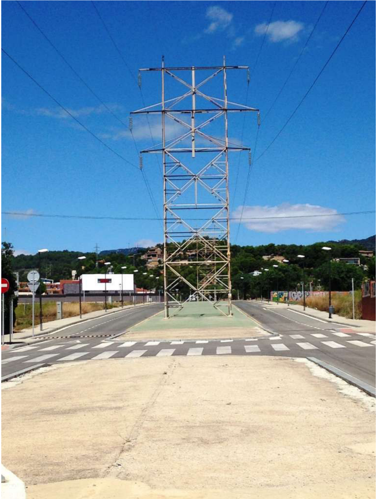
Fig 6: Torre d'alta tensió línia Reus - Serós de l'Avinguda de les Torres al terme municipal de Castellvell pròxima al carrer Vallespir.
