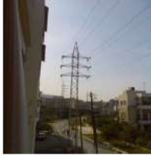
Fig. 1 : Pas de la línia de 66 kV per Kalamoun.
