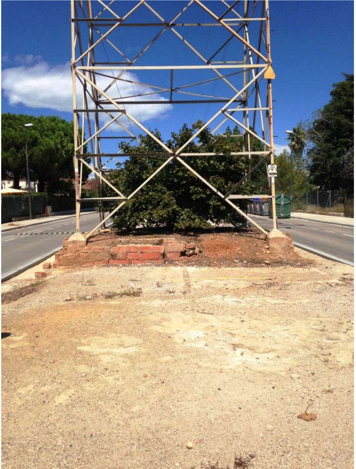
Fig 9: Torre d'alta tensió línia Reus - Serós de l'Avinguda de les Torres al terme municipal de Reus pròxima a l'Avinguda dels Pins detallant el mal estat del forjat d'aquesta.
