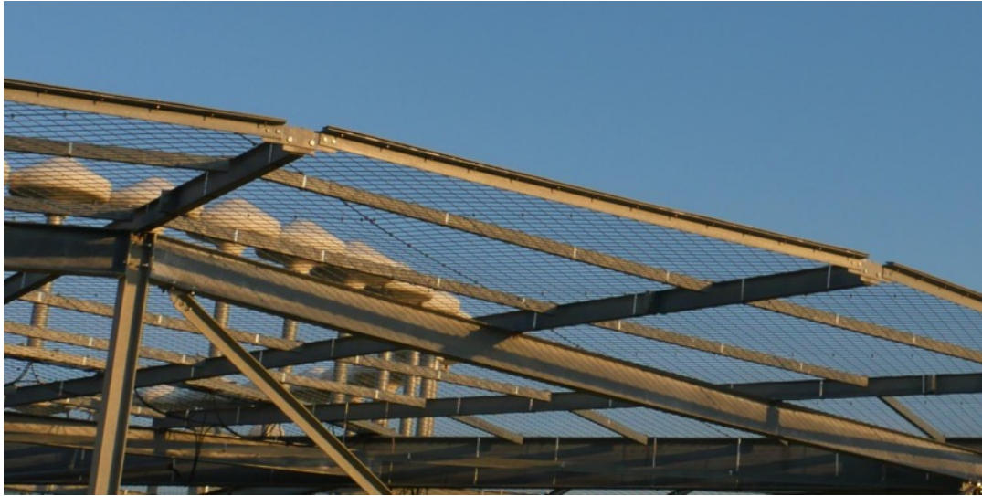
Figura 25. Malla metálica de debajo de las antenas.
