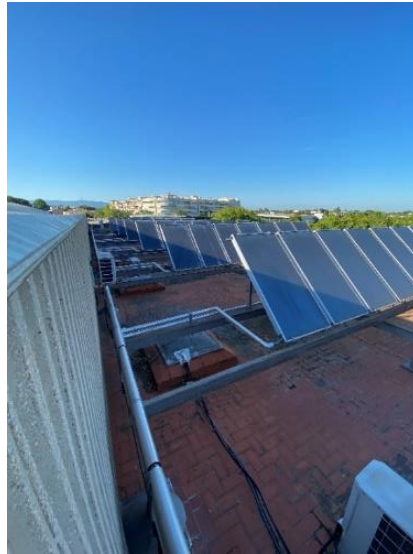
Figura 1. Instal·lació existent de col·lectors solars
