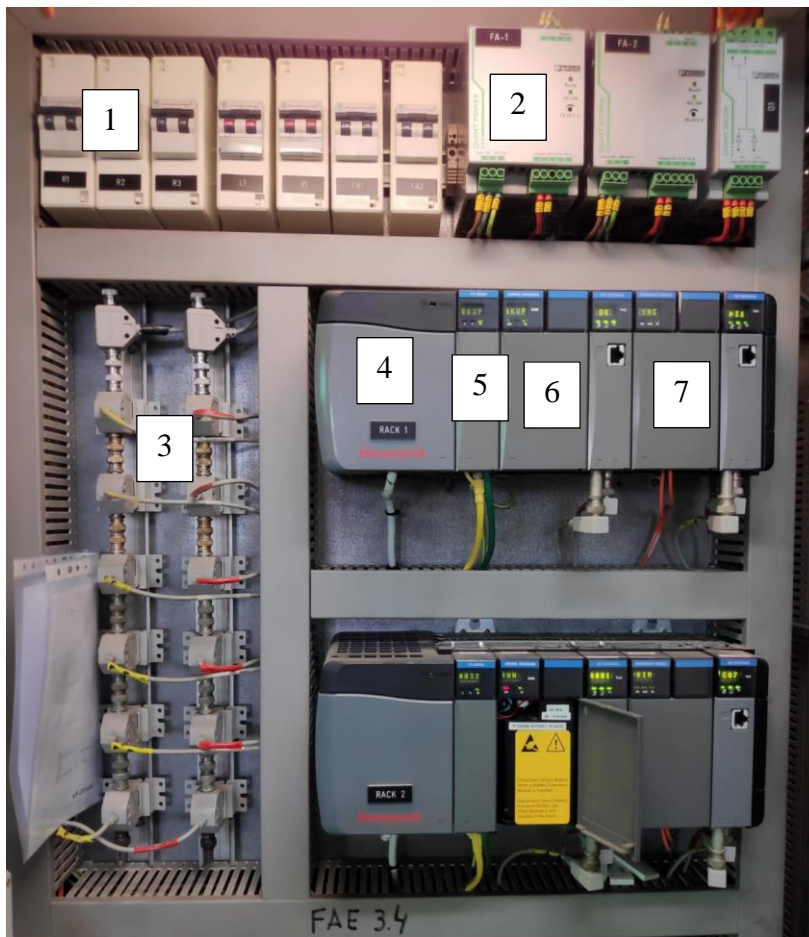
Figura 4.1.2. Mòduls de l'armari de Honeywell .
