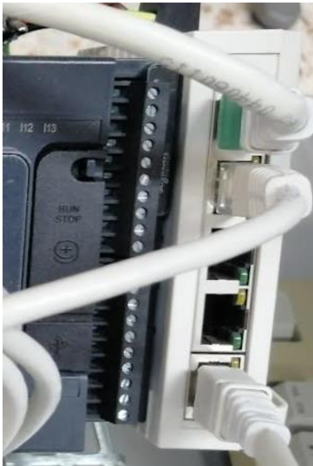
Ilustración 8. Switch Ethernet en la maqueta de prácticas.
