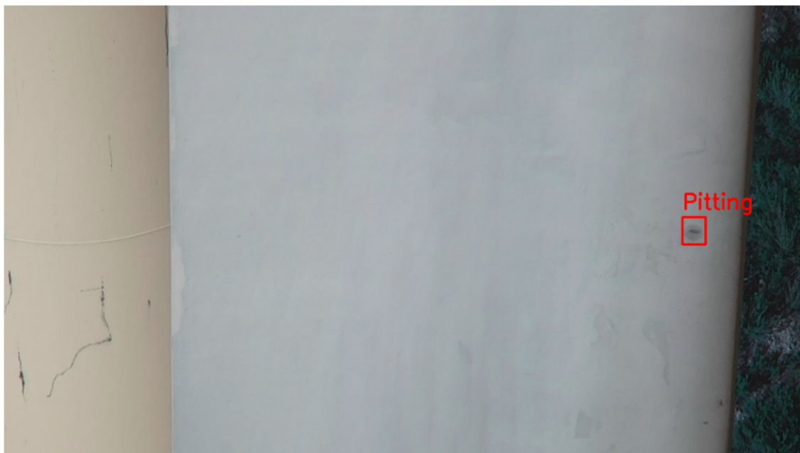
Figura 7: Exemple pitting. Font: EbreDrone
