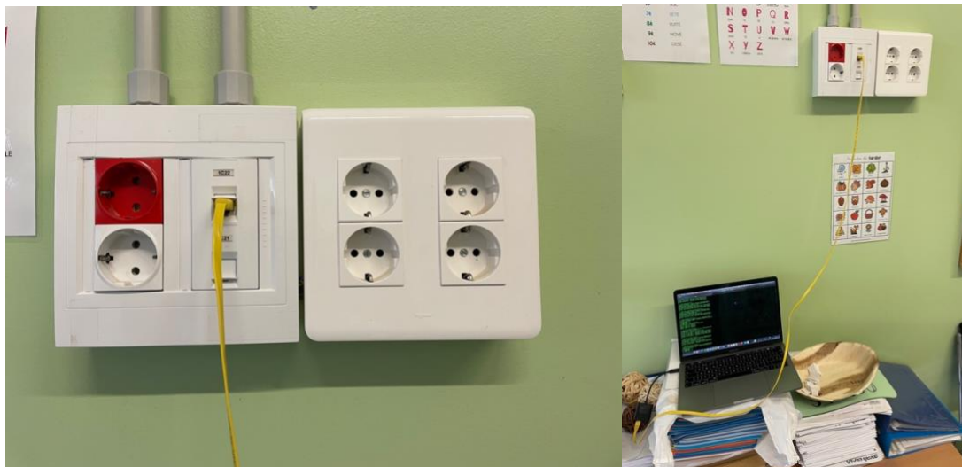
Figura 20. Presa RJ-45 i de connexió La Vitxeta
