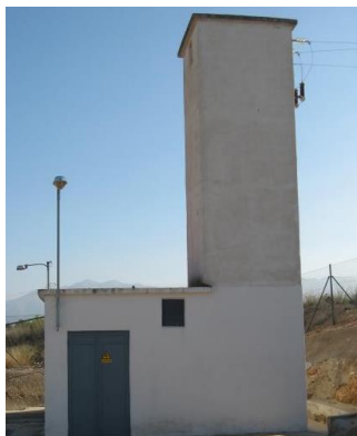
Figura 15. CT edificio de obra civil
