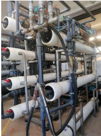
Figura 21. Equip d'osmosi inversa de Deseuras.
