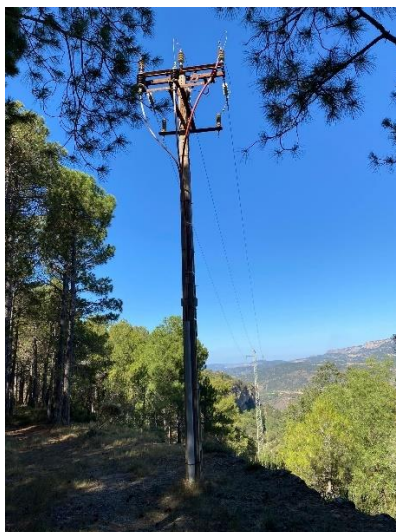
Figura 20: Entronque (MT), el cual alimenta el CT de la iError! No se encuentra el origen de la referencia.
