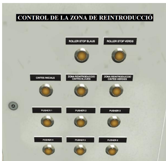
Figura 18. Mòdul esquerre del bloc 2: Botonera 3. Control de la zona de reintroducció
