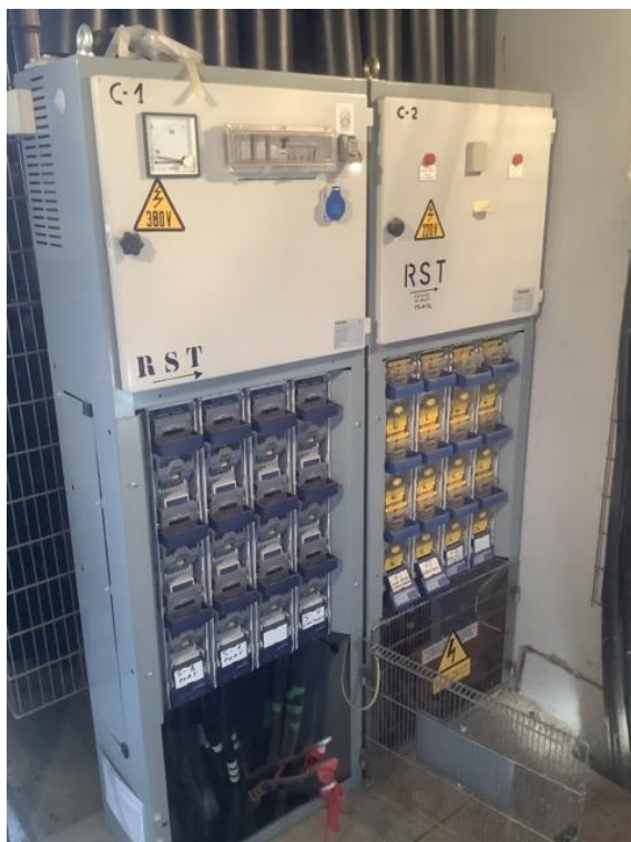
Figura 8. Fotografía de ejemplo de dos CBT con 4 salidas cada uno. Fotografía propia.
