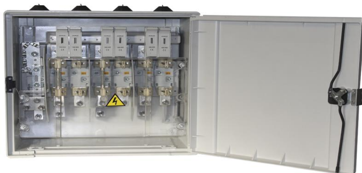
Figura 10. Vista interior de una CDU. Web https://pinazo.com/pnz-acdu-400a-end-ref--480016-1 .
