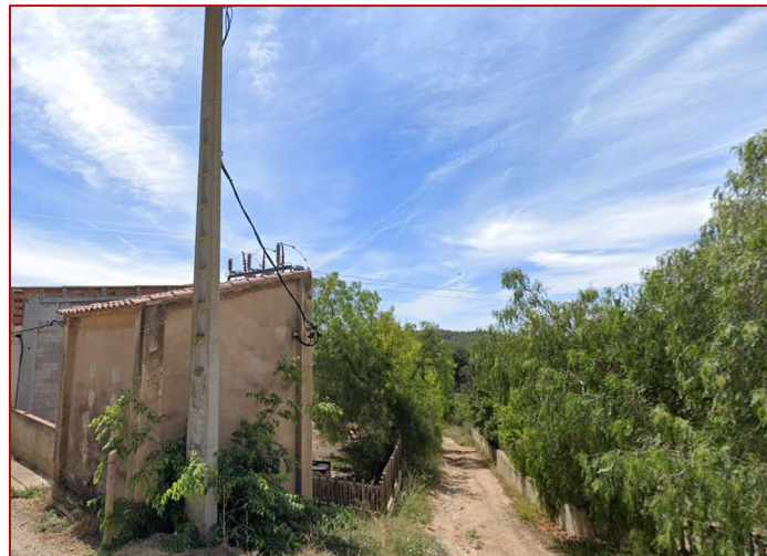
Figura 17: CT existent amb entrada de línia 25kV. Font: Google Street View, de maig 2019.
