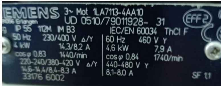
Figura 11. Placa de características del motor de 4 kW
