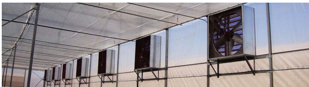
Figura 22. Ventilación forzada de un invernadero. [23]
