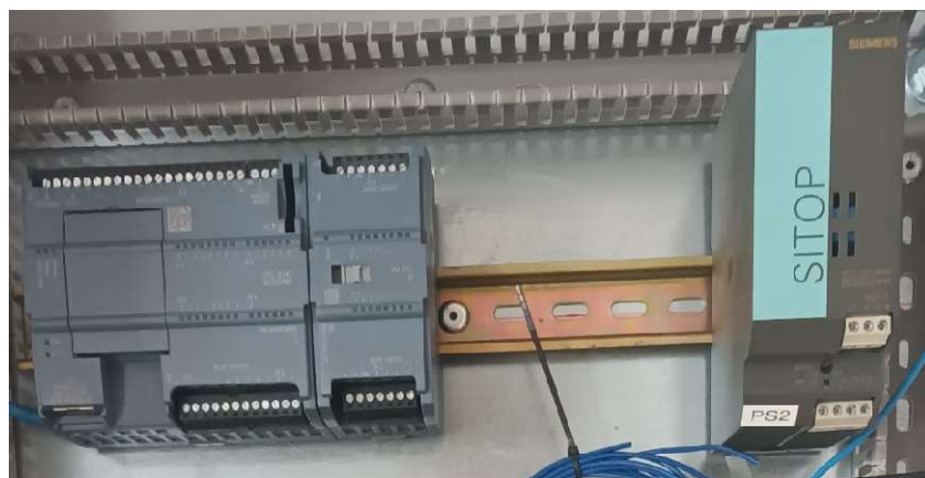
Figura 25: Part superior del quadre elèctric (control).
