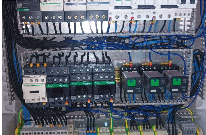
Figura 27: Actuadors (sense cablejat de control): contactors i relés.
