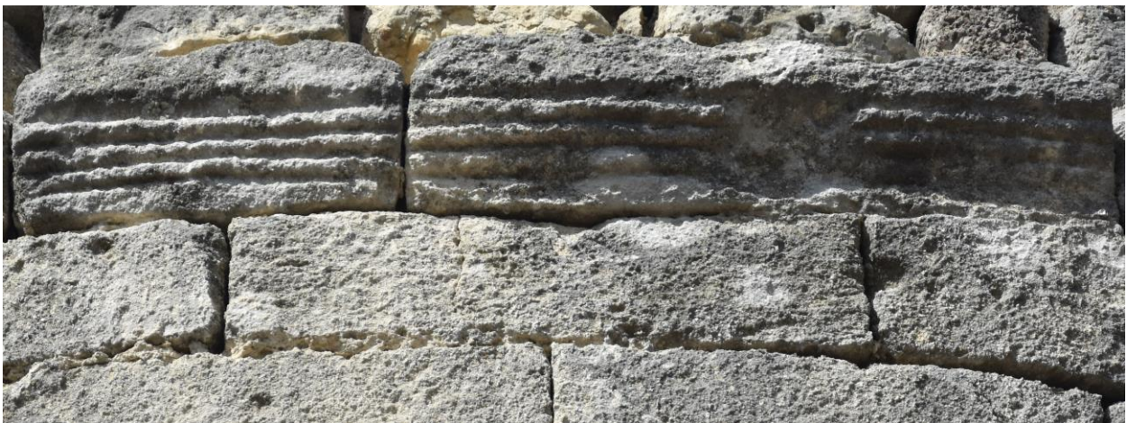
Figura 64. Detall de la simple cornisa motllurada de la Torre de les Gunyoles (Elaboració pròpia).
