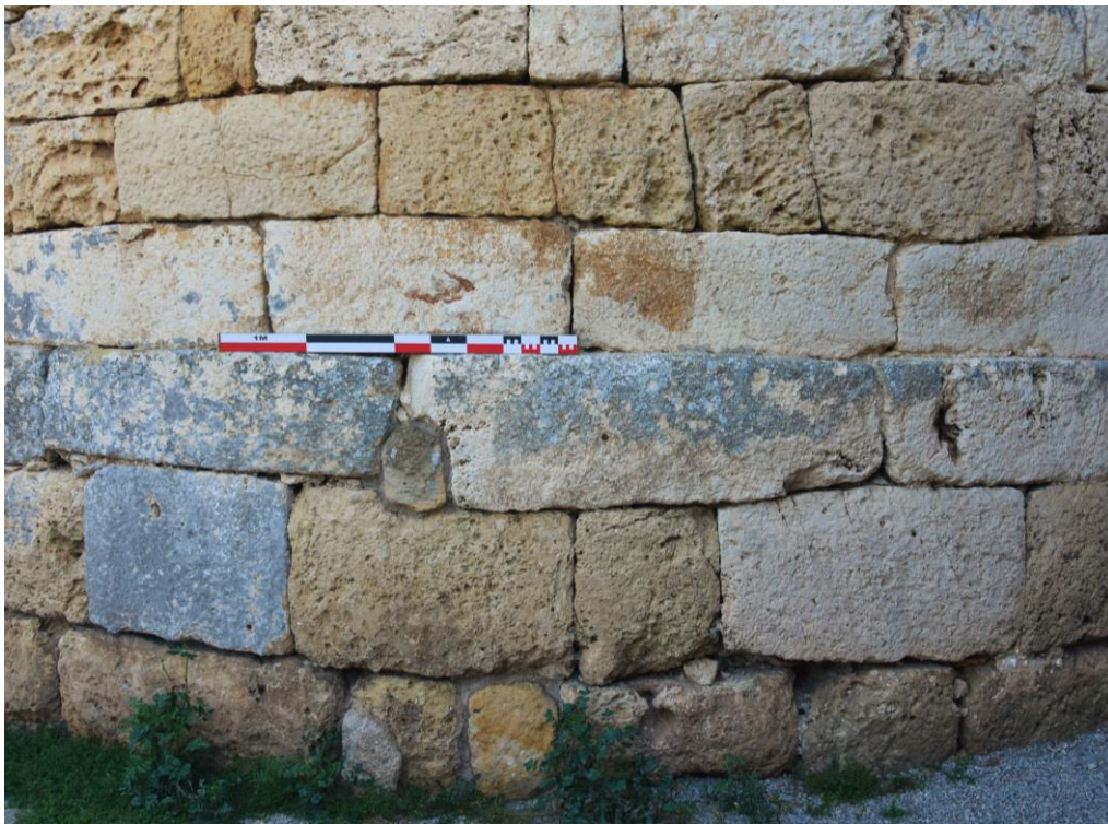
Figura 89. Sòcol i primeres filades del cos conservat, on s'observa perfectament la corba del parament per assolir la planta circular (Elaboració pròpia)
