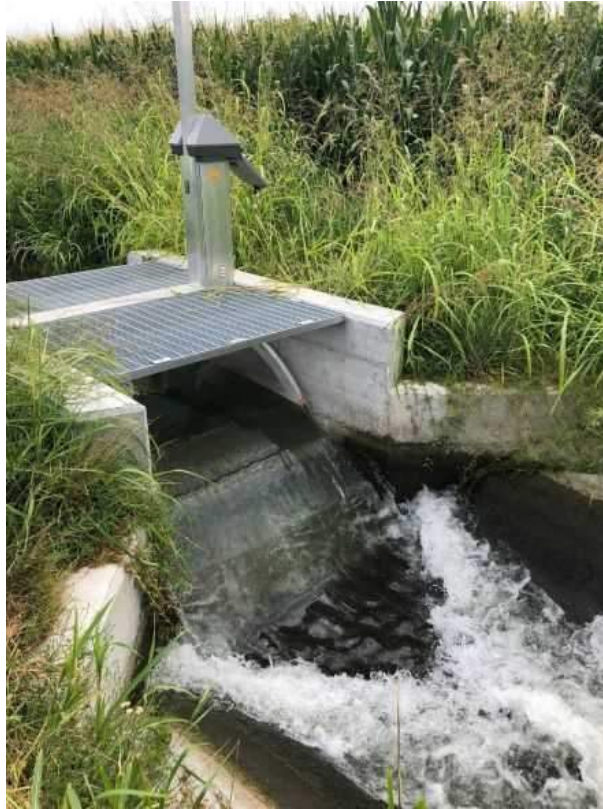
Figura 6: FlumeGate™ instalada en la Emilia-Romaña, Italia. Fuente: Rubicon Water e Ignasi Pruna
