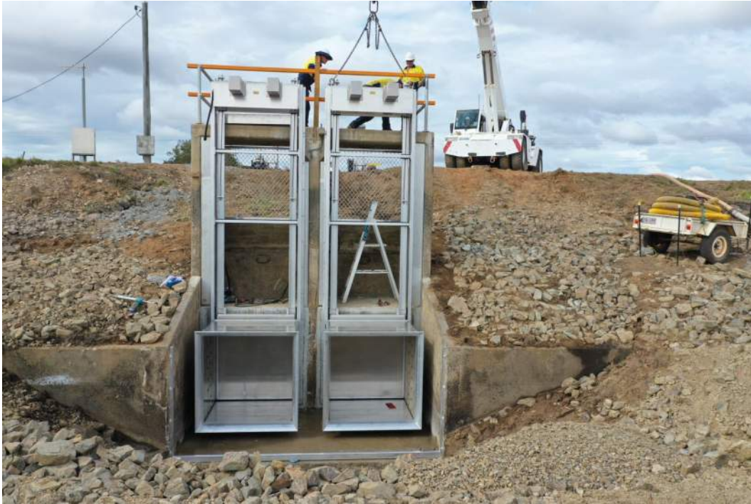
Figura 70: Instalación de 2 SlipMeter™ en paralelo en el lateral de un canal. Fuente: Rubicon Water
