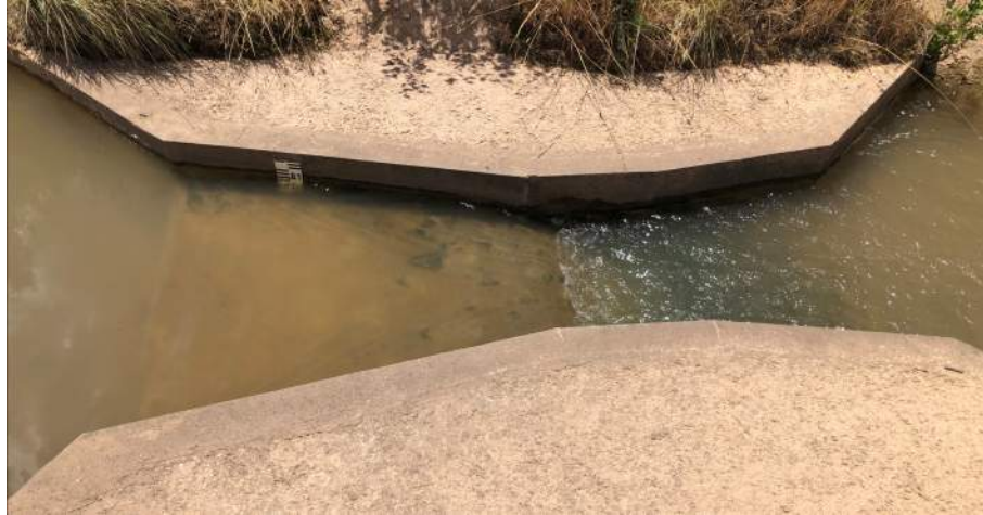
Figura 12: Canaleta Parshall instalada en el sistema de canales de Canals d'Urgell . Fuente: Rubicon Water e Ignasi Pruna
