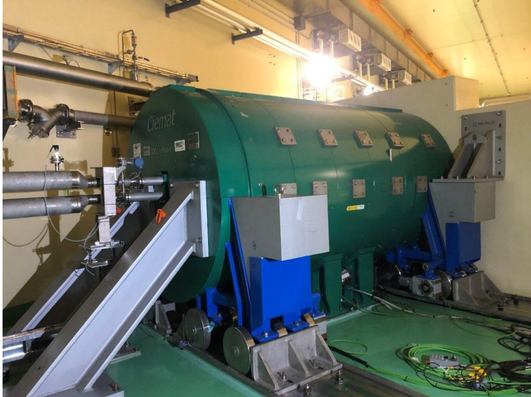
Figura 27. Imagen de la instalación del Beam Dump en Rokkasho. (IFMIF Webpage, s.f.)
