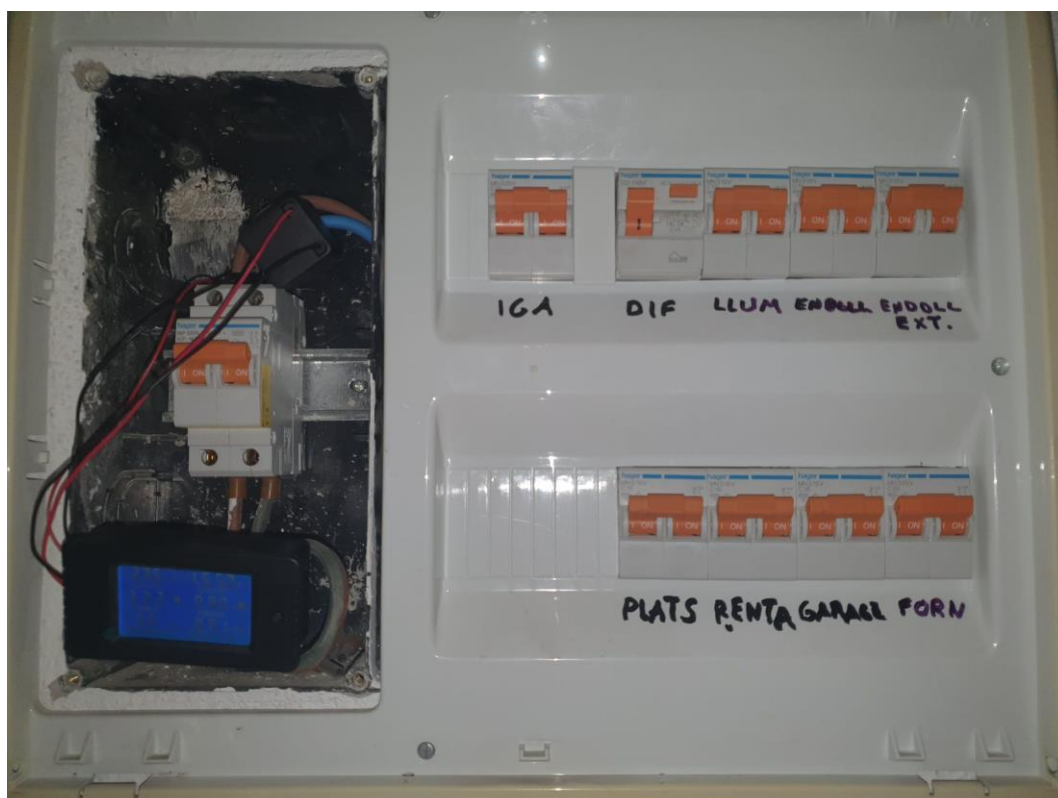
Il·lustració 10. Quadre elèctric habitatge unifamiliar de la comunitat
