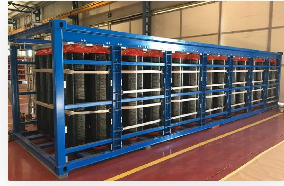
Ilustración 15: Imagen de un rack de depósitos de H2
