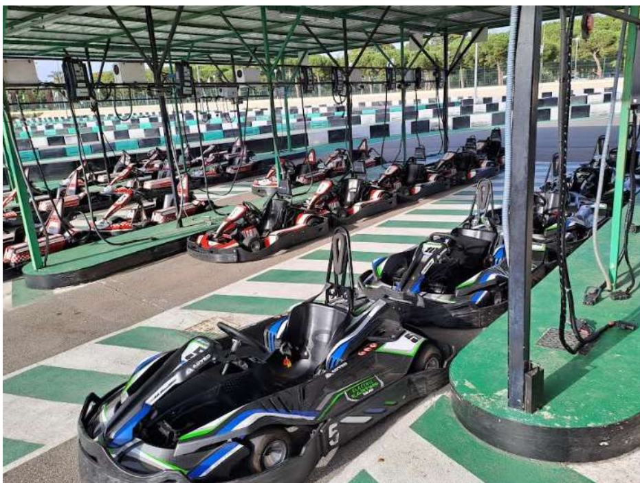
Figura 6.2. Instal·lació de càrrega dels karts del Karting Electric Salou. (font pròpia)
