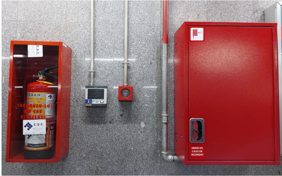
Figura 160. Exemple de BIE ancorada a la paret
