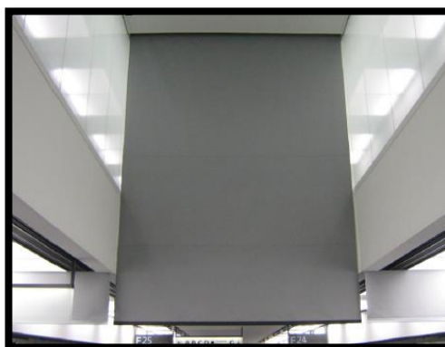
Figura 20. Barrera de fum utilitzada (Colt Smoke Master E) 17
