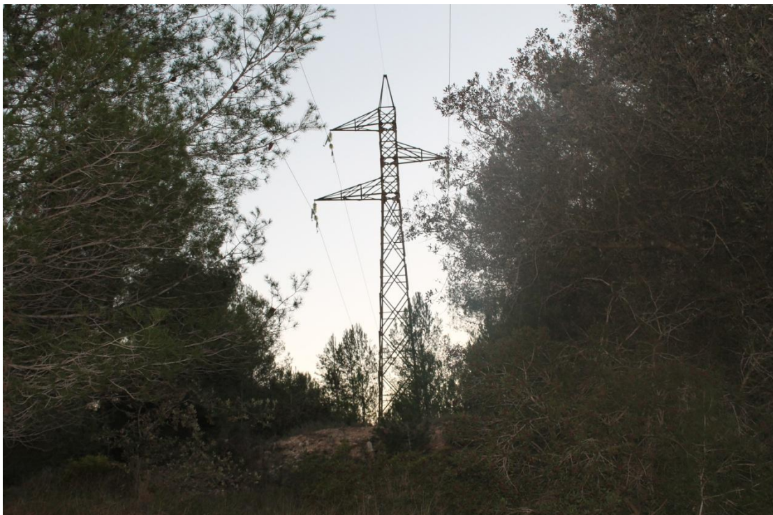
Fotografia 6.6: Torre d'alta tensió a Pallaresos Park
