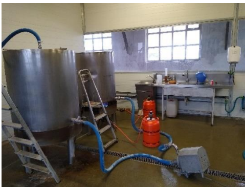
Figura: 3 Vista de l'obrador amb ambdues olles connectades a través de la bomba
