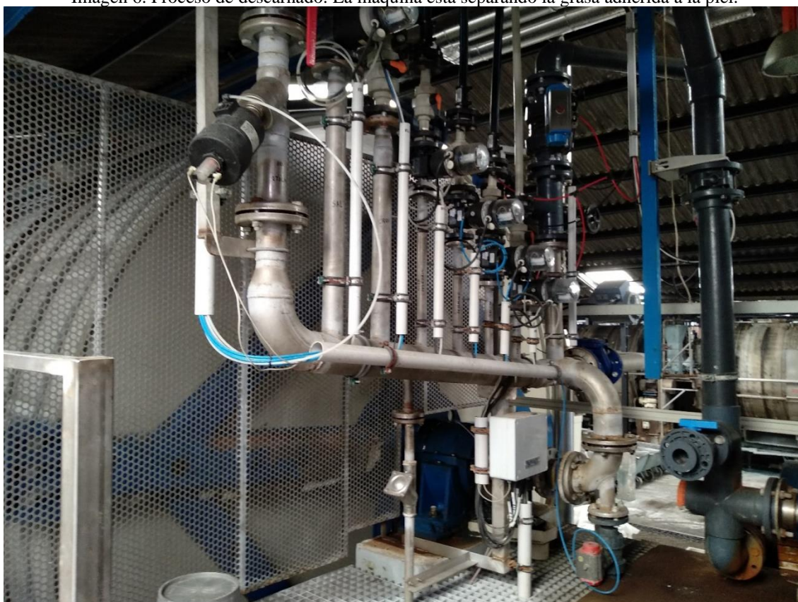
Imagen 7. Sistema de tuberías de entrada de productos automatizados.
