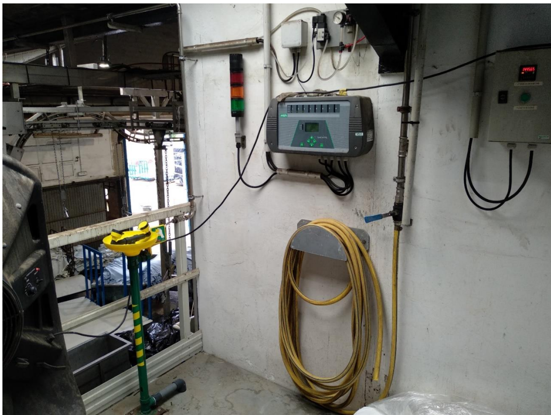
Imagen 13. Lavaojos, manguera y detector fijo de ácido sulfhídrico instalados en el lugar de trabajo
