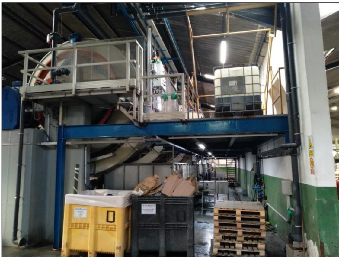
Imagen 14. Vista lateral de la estructura con el reactor y el altillo con el la zona de carga y descarga.
