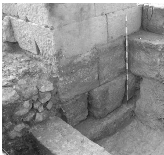
Figura 12. Cimentación del ángulo NE de la curia sobre un lecho de albero. En la parte inferior se observa el lienzo perpendicular que une la línea de tabernae y la propia curia con el borde de la plaza. Ese lienzo servía de asiento a las columnas que formaban el doble pórtico meridional.
